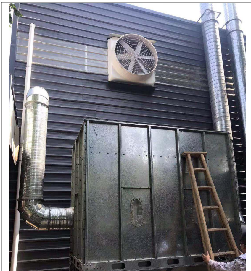
投料废气处理设施
