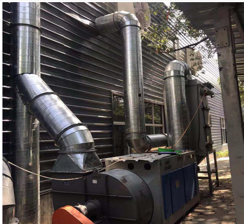
挤出废气处理设施
